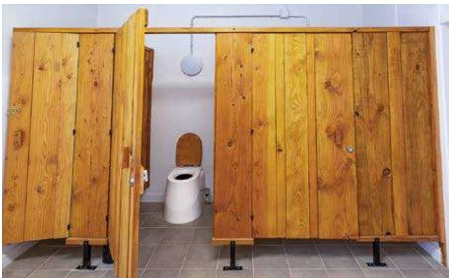
Baños secos instalados.
