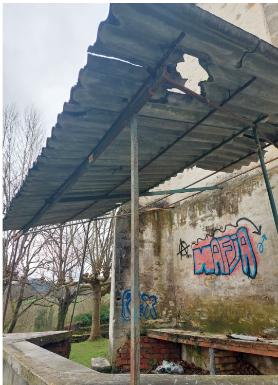
Placas en cubierta
