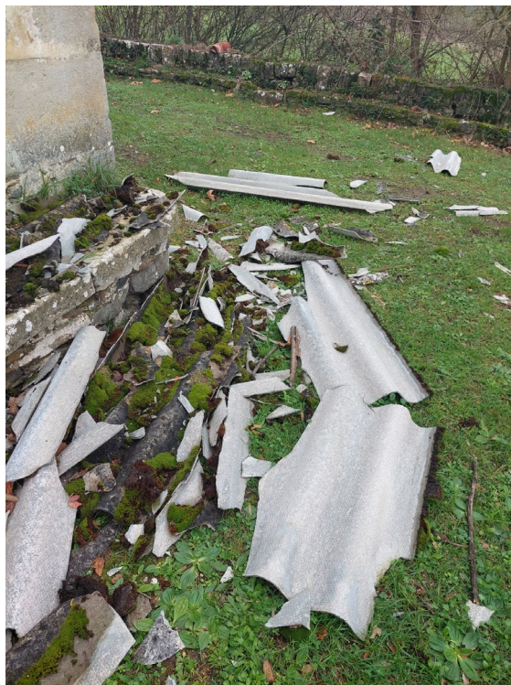
Placas rotas en el suelo
