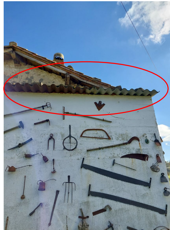
Placas en cubierta
