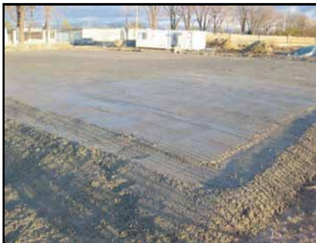
Foto N°10.13: Drenaje perimetral en zona de almacenamiento temporal
